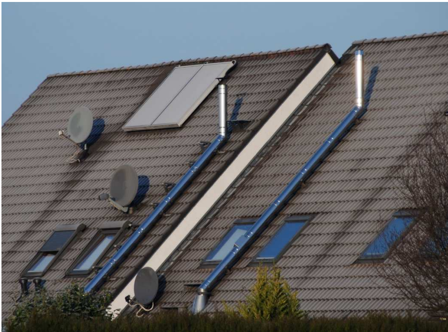
Bild 5: Dieser Lösungsansatz ist baurechtlich nicht zulässig!
