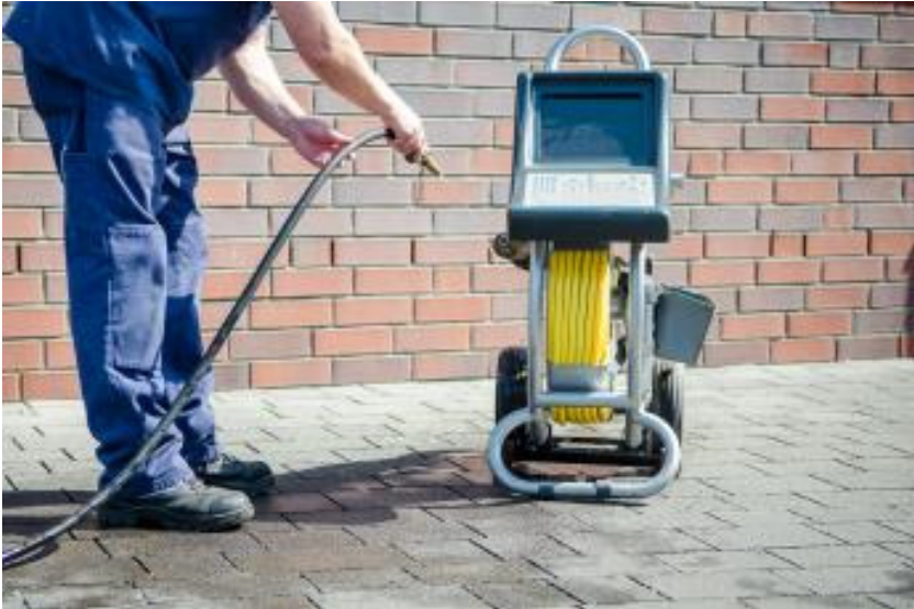
Reinigung Hausanschlusskamera (Quelle: BWB)
