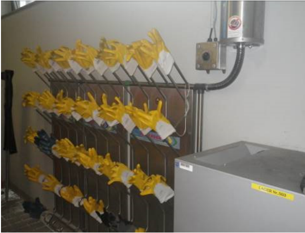
Beispiel: Trocknungsanlage für gereinigte Handschuhe (Quelle: BWB)
