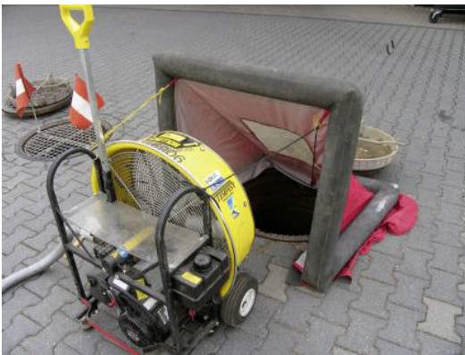
Beispiele: Einsatz von Kanallüftern (Quelle: SEBD)
